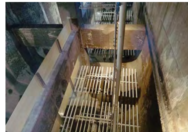
新河岸水再生センターでのミクラス設置事例
