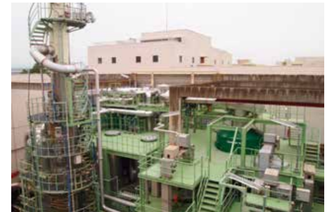
写真-2 浅川水再生センター汚泥焼却設備全景
